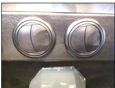
Рис. 27Г - Выходные заплюпочные клапана отопления - закрытые
