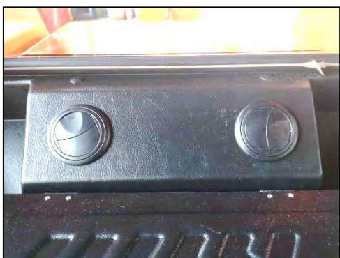
Рис. 27Е- Выходные заплюпочные клапана отопления - закрытые
